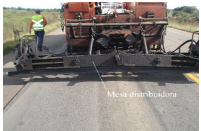
Figura 3A. Mesa distribuidora. Fonte: Autores
