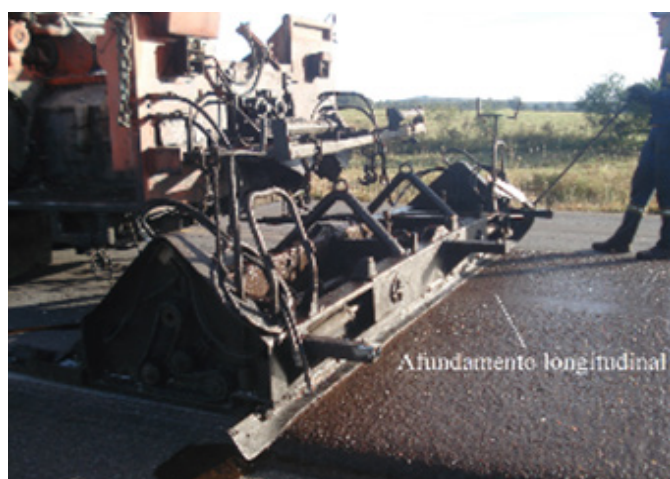
Figura 4A. Afundamento longitudinal. Fonte: Autores
