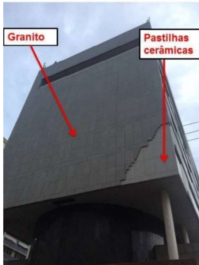
Figura 5: Fachada Norte, recorte no granito deixando aparentes as pastilhas cerâmicas. Fonte: Registro fotográfico realizado pelo autor, 2021. Adaptado pelo autor.
